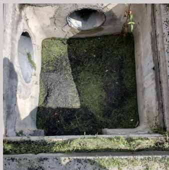
集水柵には人工芝と ゴムチップが堆積している
